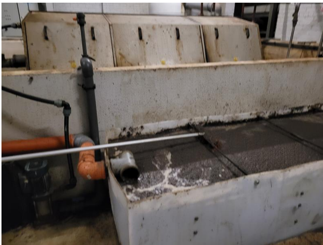
3.9 pav. Būgninio filtro praplovimo vandens surinkimo talpa su surinktais riebalais
